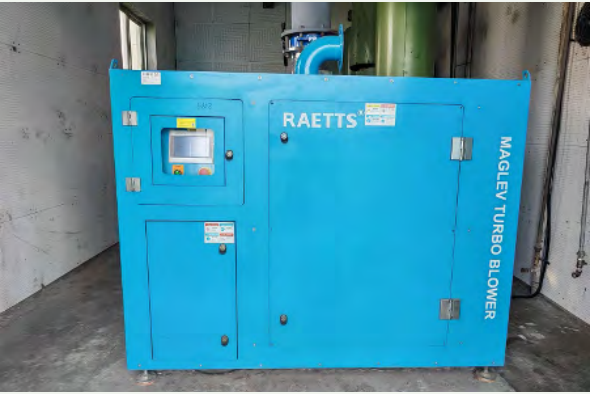
供应商水处理曝气机改造
